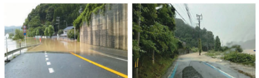
小津田地区 被災状況
