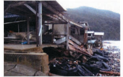
平成29年 台風21号 被災状況
